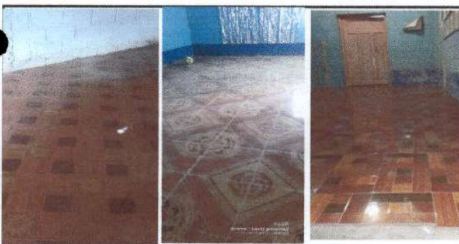
Foto 5: sustitución de torta de concreto por cerámico en cocina, dirección y modulos 1 y 2 por estar en mal estado.
